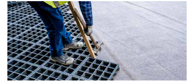
Auf enge Verlegung und regelmäßiges Nachklopfen achten, um eine spätere Fugenbildung zu verhindern.
